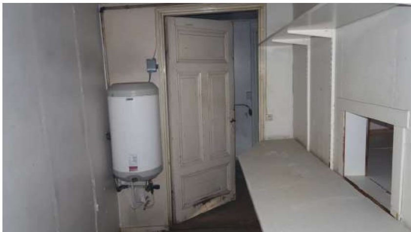
Figur 3. Ytskikt och inredning med behov av totalrenovering
