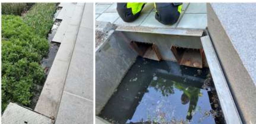
Figur 8. Bilden till vänster visar trapporna som skyfallsvattnet leds ned längs med till dammen. Bilden till höger visar inloppet från Birger Jarlsgatan till dammen (vanligtvis dolt med ett lock) där skräp samlas upp innan vattnet leds in i dammen.
