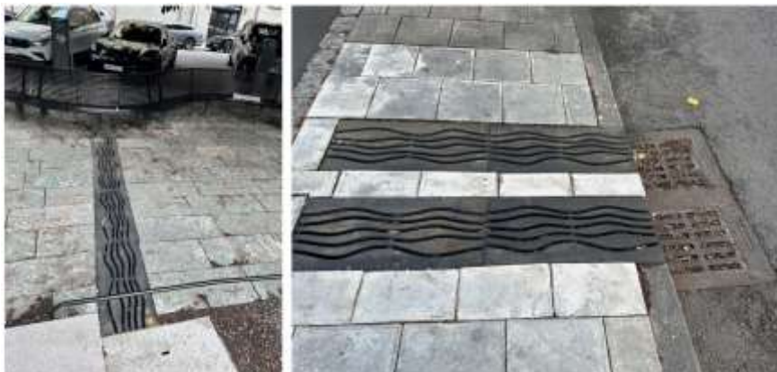
Figur 7. Bilderna visar skyfallsrännor och brunnar som leder in vattnet till skyfallsparken.
