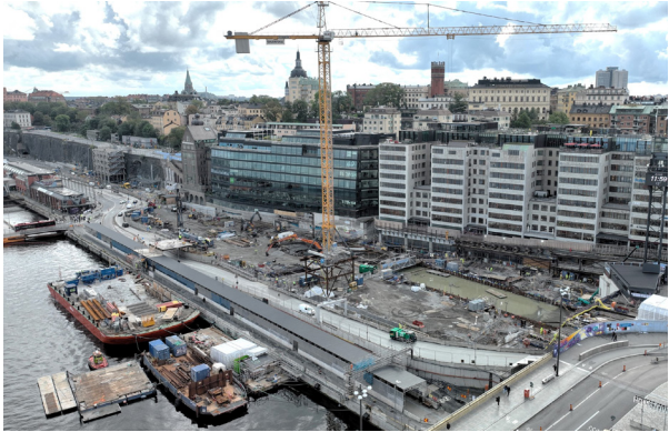
Platsen framför Glashuset och Katarinahuset har under lång tid använts för kommunikation som för bilar, bussar och Salt-sjöbanans spårtrafik. Idag pågår byggnation av nya Slussen. Foto: Stockholm stad
