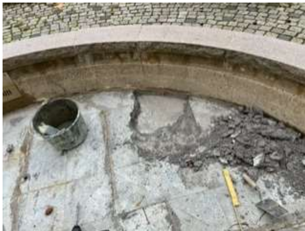
Figur 2 Fotografi som visar fontänbotten före renovering
