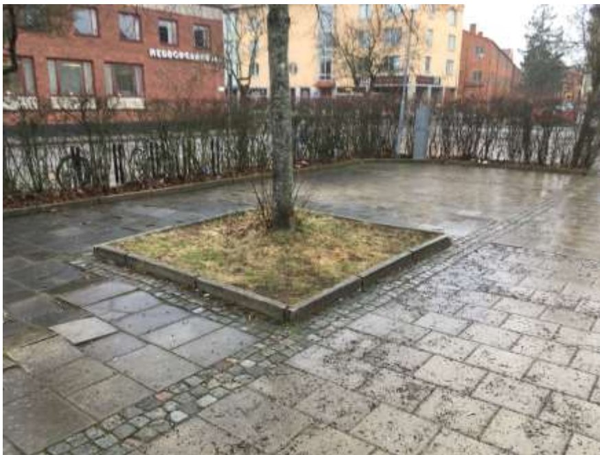
Bild 5. Fotografi som visar träd i gammal planteringsyta före ombyggnationen. Trädet bedöms som livskraftigt men är i behov av en växtbäddsrenovering. Bredvid planteringsytan är beläggningen ojämn på grund av rotuppträngning.
