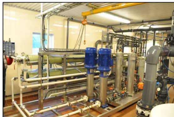
Bild 11: Skärgårdsstiftelsens avsaltningsanläggning på Utö gör dricksvatten av havsvatten. Foto: Martin Ragnar
