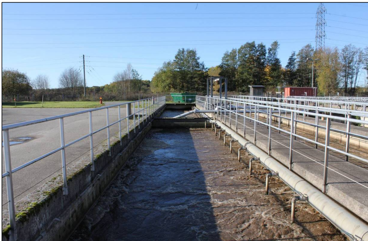
Bild 15: Reningsbassäng på Fors reningsverk. Foto: Hedda Ericsson
