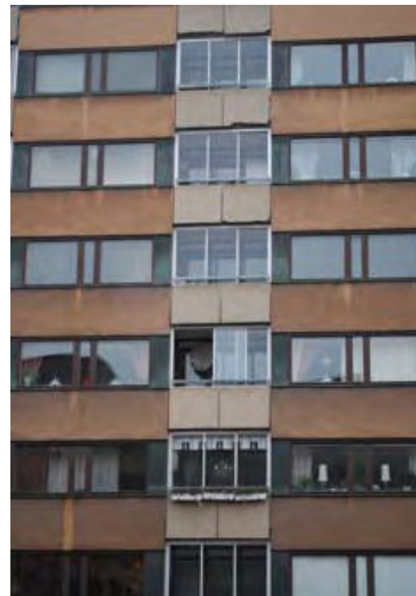
Balkongfronter behöver bytas ut
