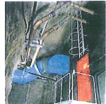
32. Ledningar för avgaser och avgående kyl luft från kraftcentralen
