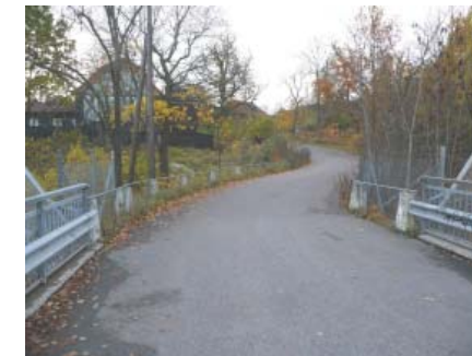
Vid järnvägsbron kantas Lögebodavägen av en äldre typ av räcken och på bron finns säkerhetsräcken av teknisk karaktär.
