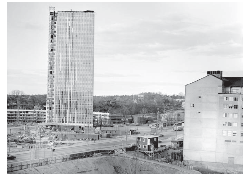
Wenner-Gren Center under byggnad. Grävarbeten i kv. Getingens östra del. I fonden Bellevue. SSM, Foto: Herbert Lindgren, 1961.
