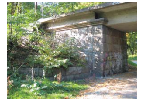
Gångtunneln under järnvägen är en mycket viktig passage centralt i parken. Dess utförande är bearbetat, men platsen är illa skött.
