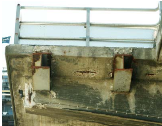
Bild 2.2 Skadad betong ovanför Stadsgårdsleden.
