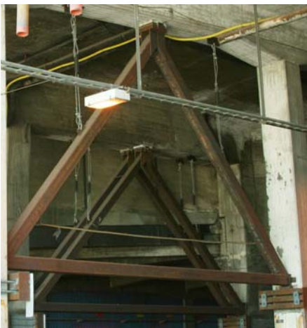
Bild 2.1: Denna metod används vid mindre allvarliga försvagningar. Åtgärden har begränsad livslängd. Bild från Stadsgårdsleden
