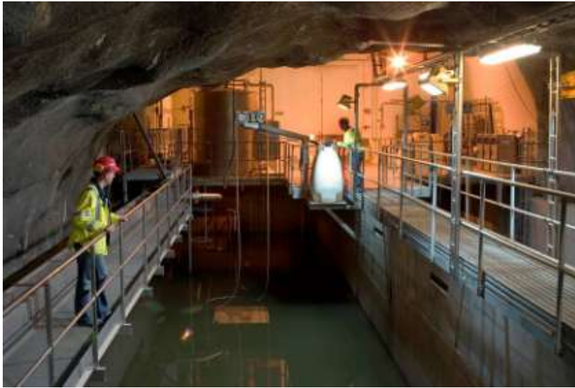
Figur 6: Södra Länkens VA-station. (Vid den borte änden av sedimentationsbassängen syns oljeskimmern samt behållaren med natriumhydroxid.)
