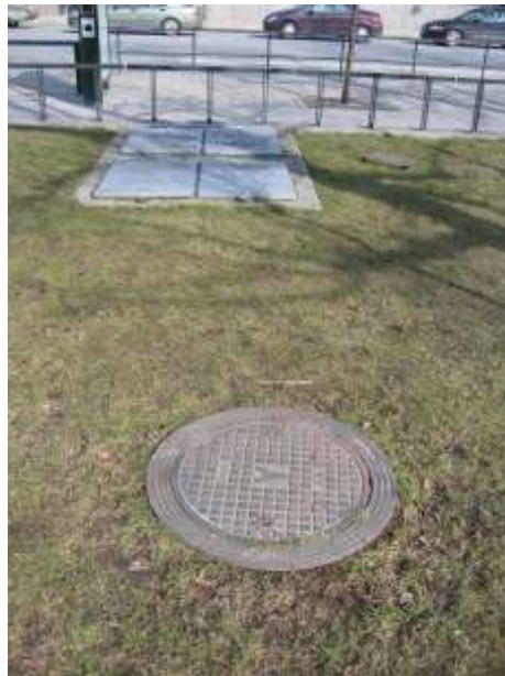
Figur 8: Avsättningsmagasinet vid Sankt Eriksplan. I förgrunden: brunnslock ovanför själva magasinet (för mätning av slammängd samt tömning av slam). I bakgrunden: mansluckor för driftpersonalen.
