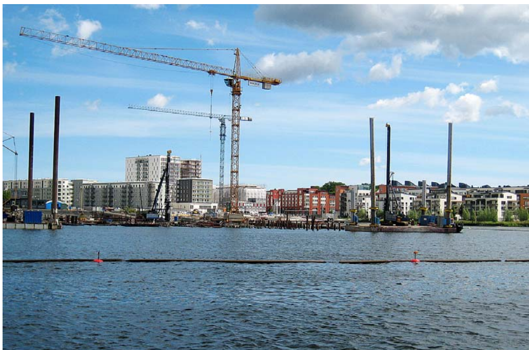
De sista etapperna av Hammarby Sjöstads utbyggnad har påbörjats, mark- och sedimentföroreningar åtgärdas kontinuerligt. Foto: Magnus Sannebro.
