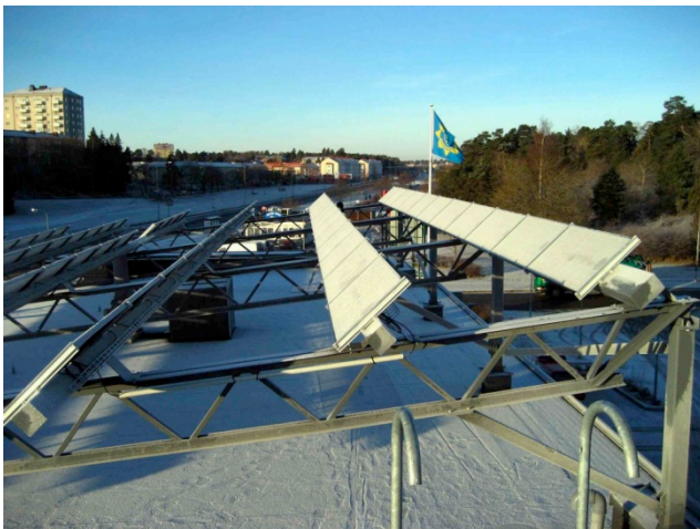
Figur 15: Solceller på Vällingby brandstation.
