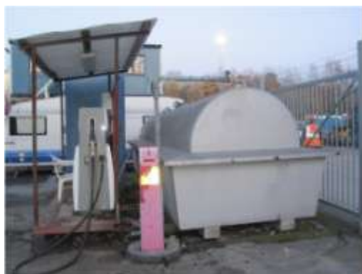
Bild 5. Tankningsställe hos Skanska Beläggning
