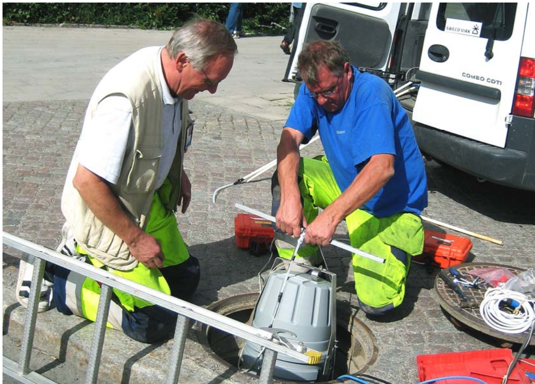
Stockholm Vatten har genomfört ett projekt i samarbete med KTH där olika dagvattenfilter för reduktion av kopparläckage från tak har utvärderats. Foto: Pia Dromberg.
