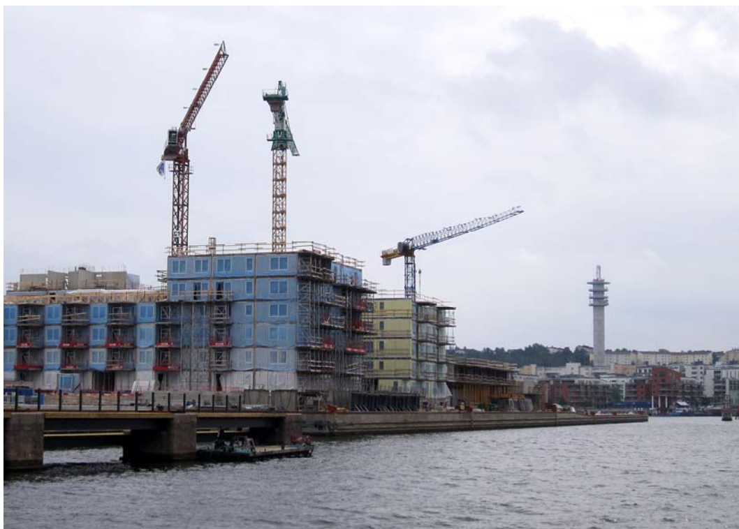
Hammarby Sjöstad växer – uppförandet av Henrikdalshamnen pågår för fullt. Detta utgör den sista större etappen av utbyggnaden av Sjöstaden. Foto: Magnus Sannebro.
