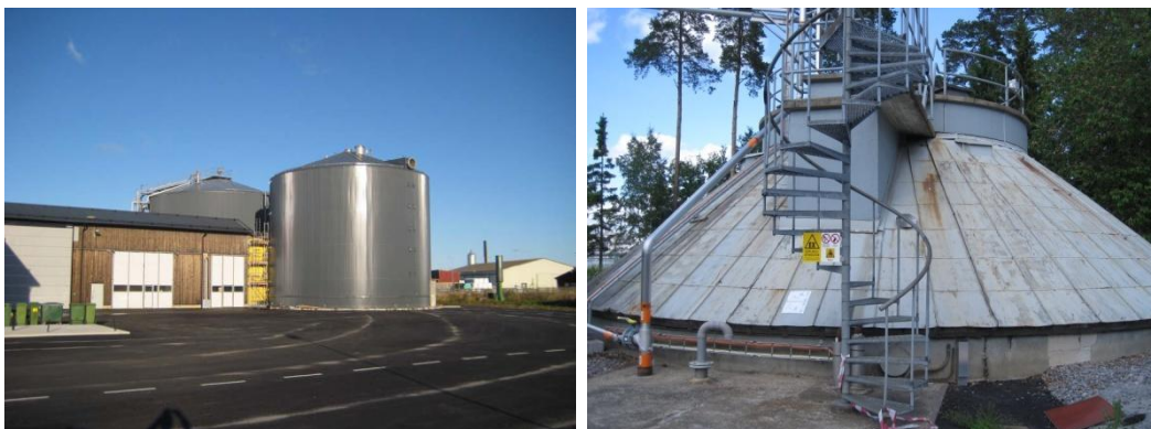
Figur 3. Till vänster: Uppsala biogasanläggning, Kungsängens Gård. Till höger: Loudden biogasanläggning, Stockholms stad, Scandinavian Biogas Fuels AB
