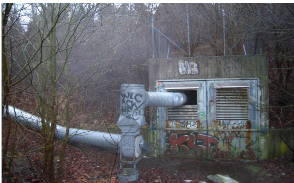
Bild 1. Visar Järva pumpstation. På bilden syns hur luft med vattenångor kommer ut från pumpstationen.
